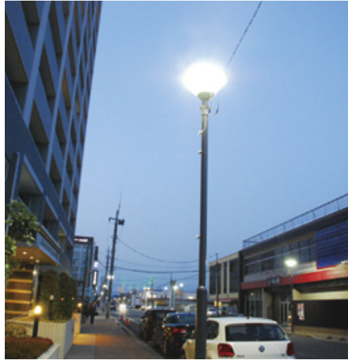
13基の街路灯をLED化した街区
