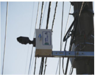
新しく設置された防犯カメラ
