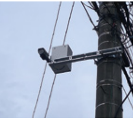
新しく設置された防犯カメラ
